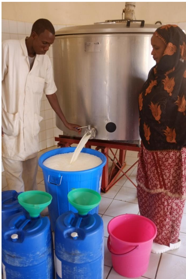
Tank de refroidissement du centre de collecte de Kollo © Karkara
