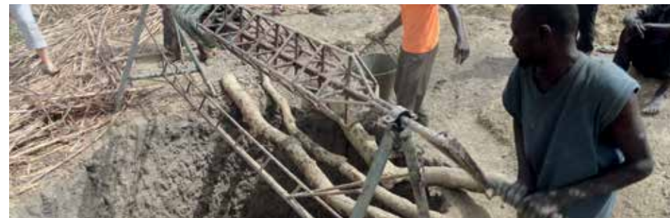
Puits en cours de construction sur un site maraicher du canton de Tami
