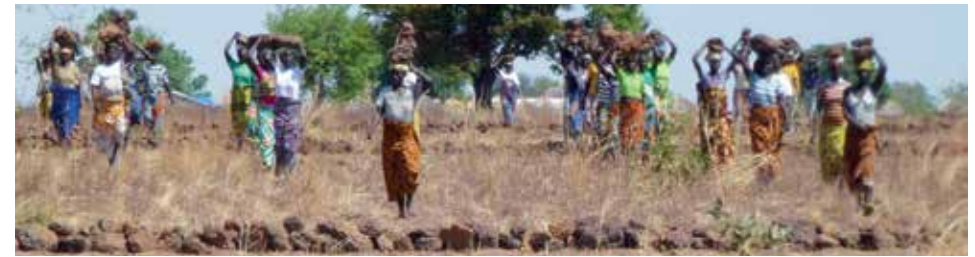
2. Transport de moellons par les femmes pour la réalisation de cordons pierreux (© T. Bakker)
